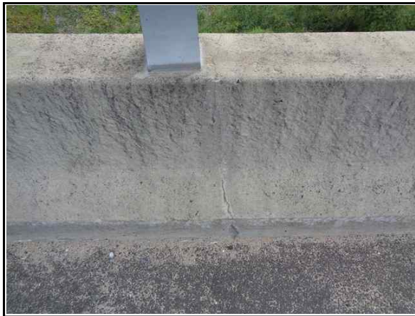
콘크리트 균열 (대구방향 S3경간)
