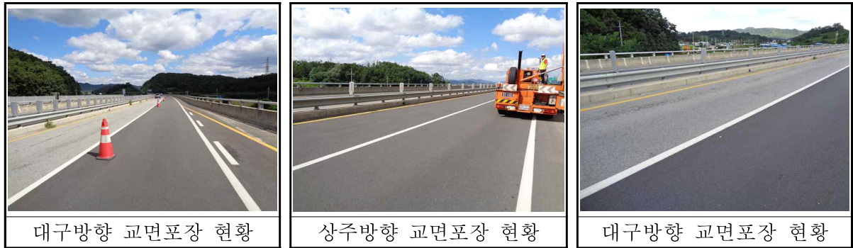
【그림 3.3】 교면포장 현황
