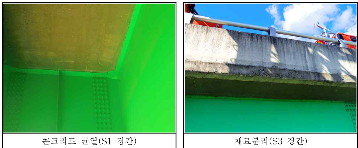
【그림 3.11】 바닥판하면 손상 현황
