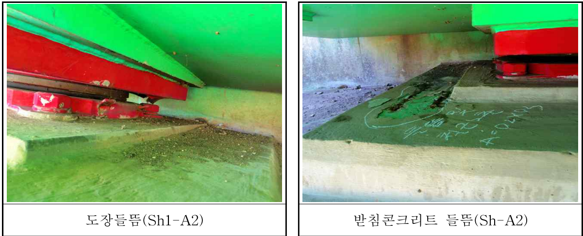
【그림 3.21】 교량받침 손상 현황
