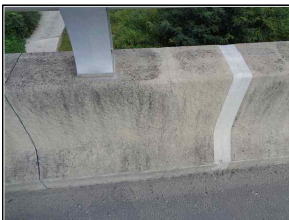
콘크리트 균열 (상주방향 S1경간)
