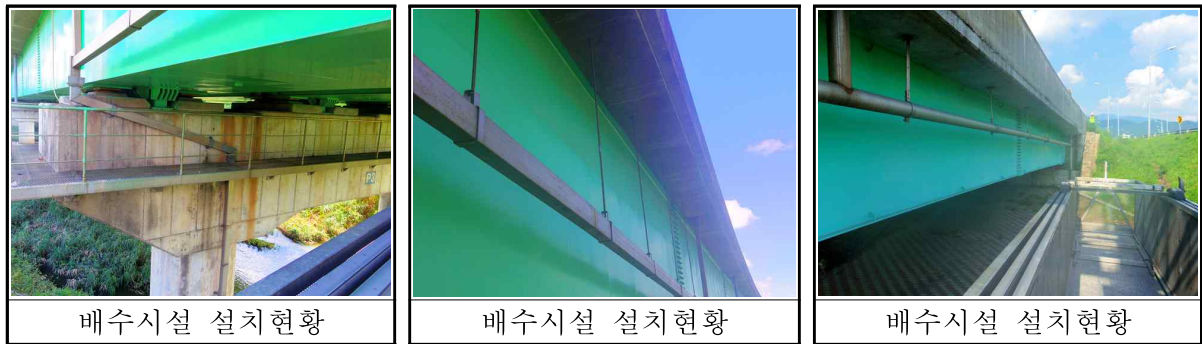
【그림 3.25】 배수시설 현황
