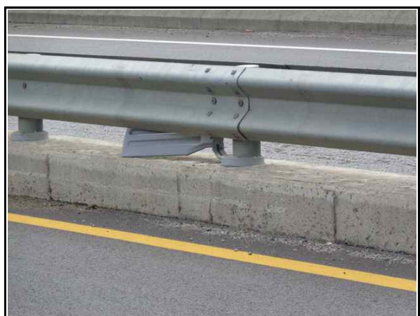
차광판 파손 (상주방향 S2경간)
